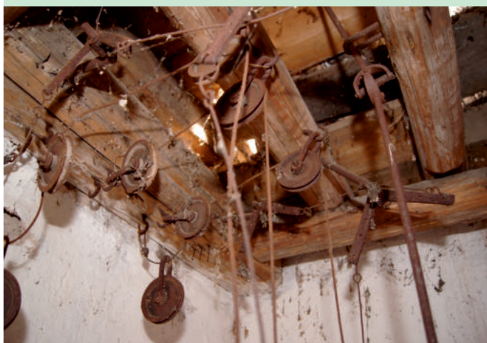
Věžní hodiny, stav před restaurováním, kladky závaží a páky bití, koroze, nečistota v mechanismech; Věž kaple Sv. Rodiny, Nahořany;
